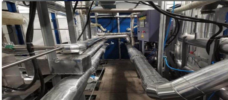
图 1 燃料电池空压机用测试设备（设备 1）
